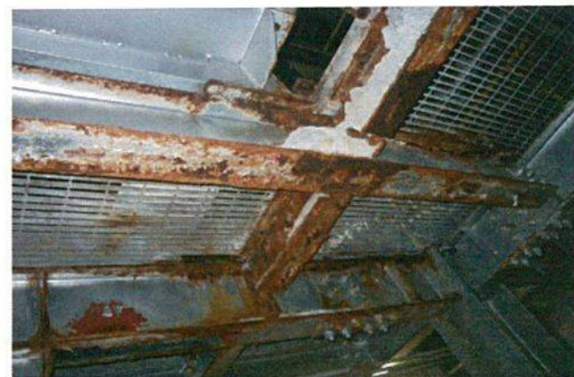
不燃物排出装置架台、歩廊
