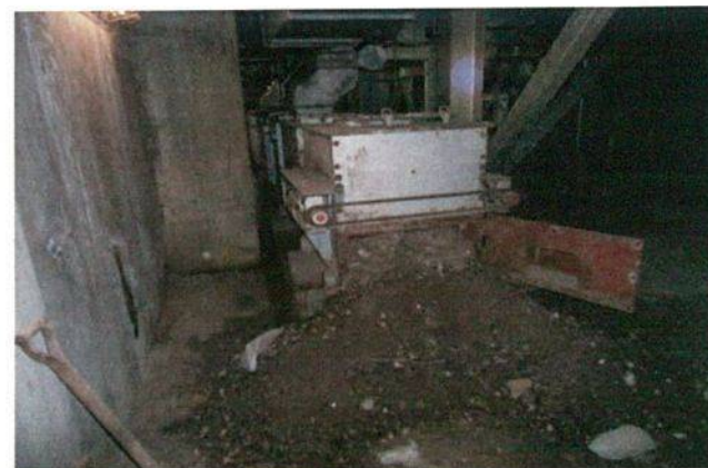
不燃物移送コンベア(1)
