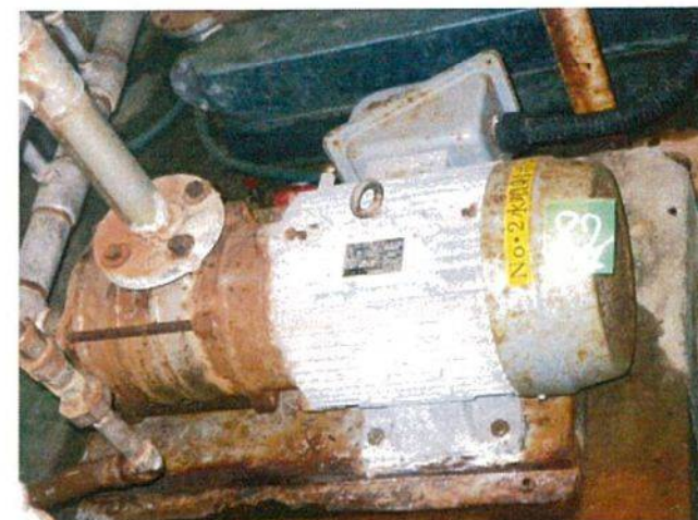
水噴射ポンプ
