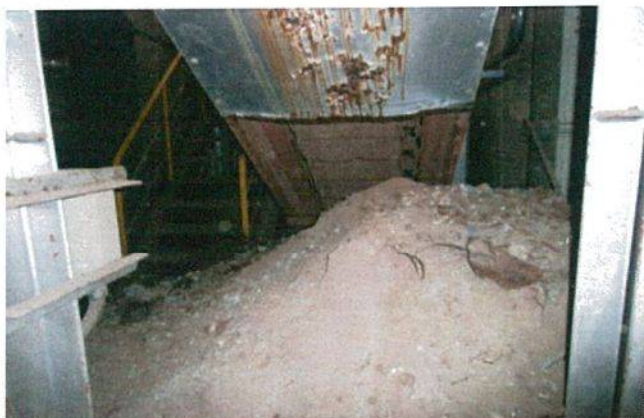
不燃物移送コンベア(2)
