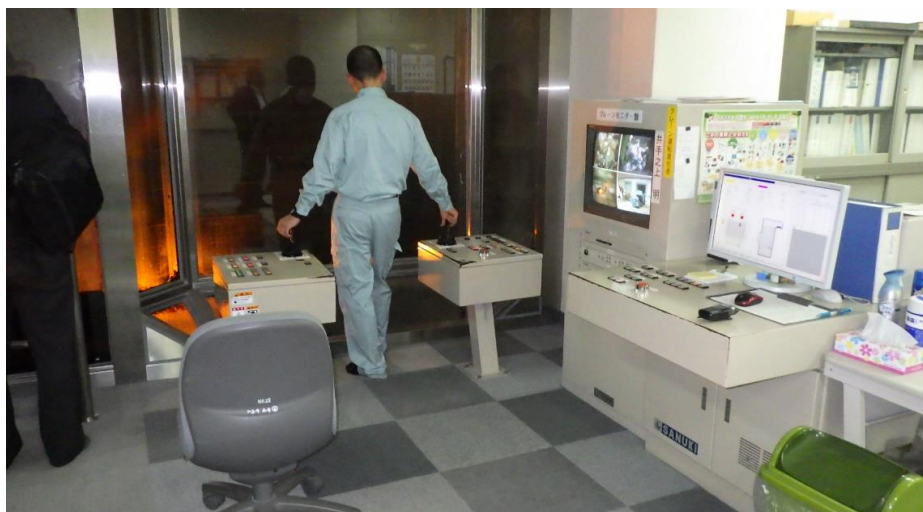
焼却施設 中央操作室
