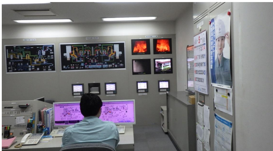
焼却施設 中央操作室
