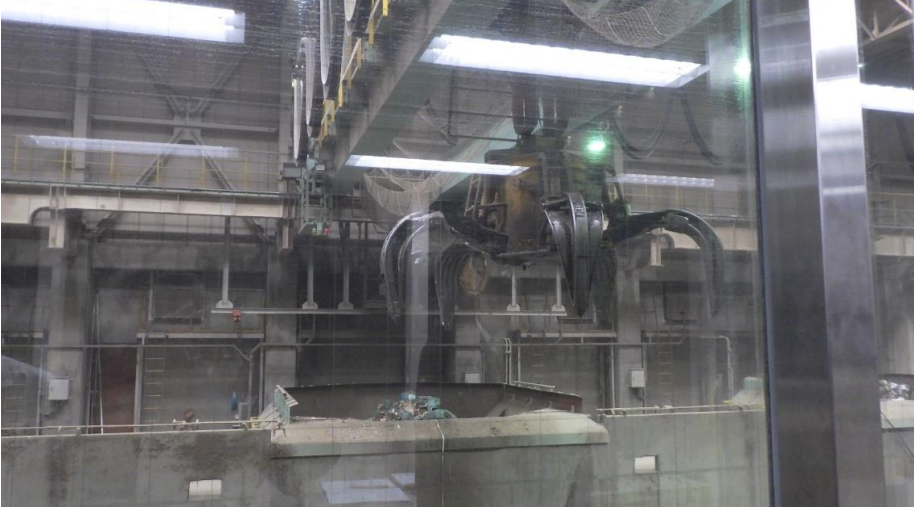
ごみクレーン
