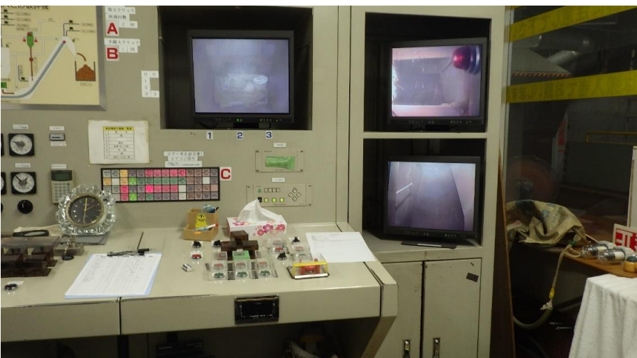
破砕機操作室
